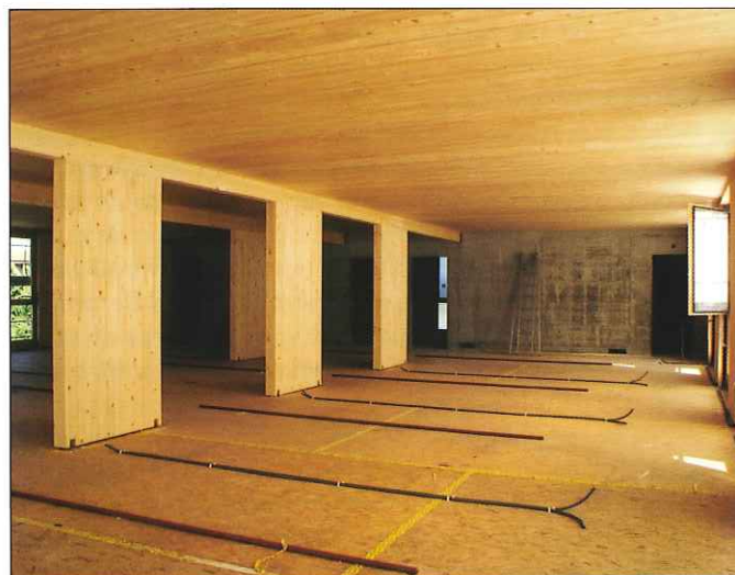
Sur les planchers contreventés par des plaques d'OSB viennent ensuite 60 mm d'isolation – espace prévu également pour le passage des installations d'électricité et de sprinkler –, une chape flottante avec le système de chauffage au sol, et le revêtement (fin août 2007).
