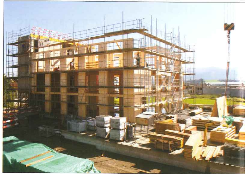
Mi-juillet 2007, montage du bâtiment en bois, qui mesure 24 m de long et 15,3 m de large pour une hauteur de 12,8 m.
