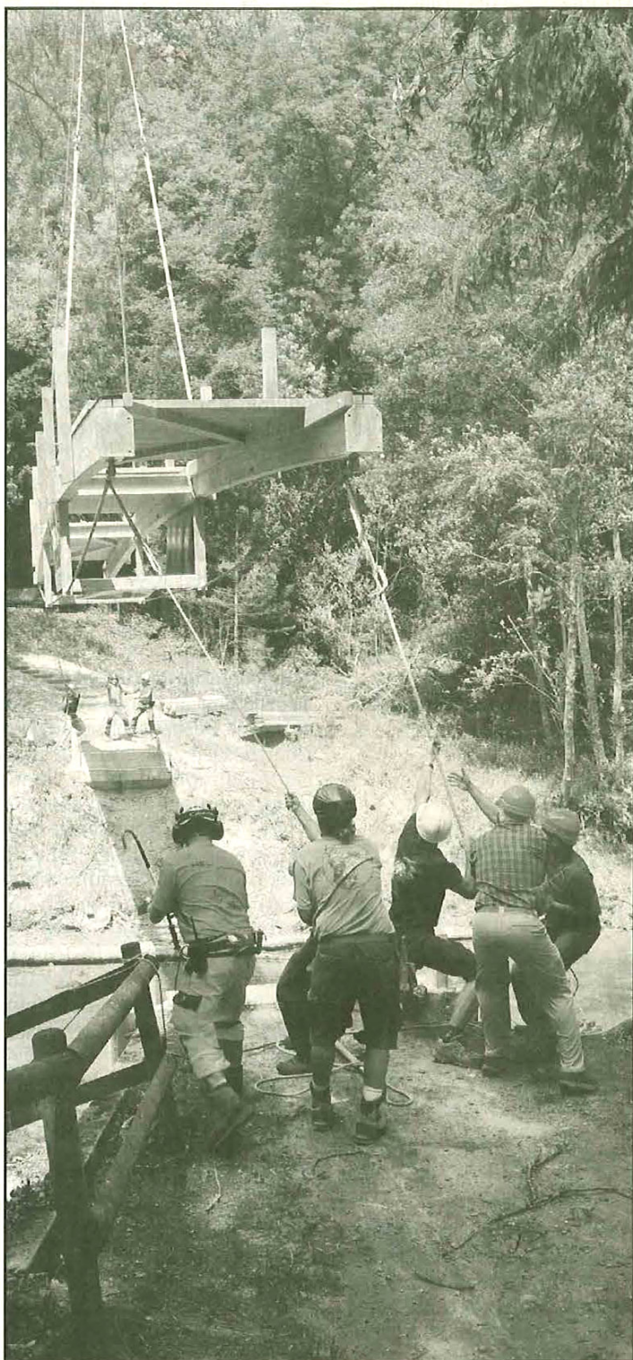
La passerelle arrive par les airs, elle sera arrimée par l'entreprise, mais les apprentis ont préparé le terrain. JULIEN CHAVAILLAZ
